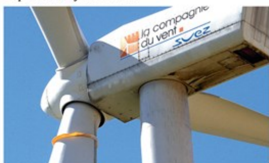
Le filtre d'étanchéité (en jaune) d'une seconde éolienne s'est détaché de sa base.
